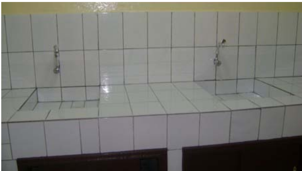
Photo 3 : janvier 2011 : équipement du bâtiment rénové
